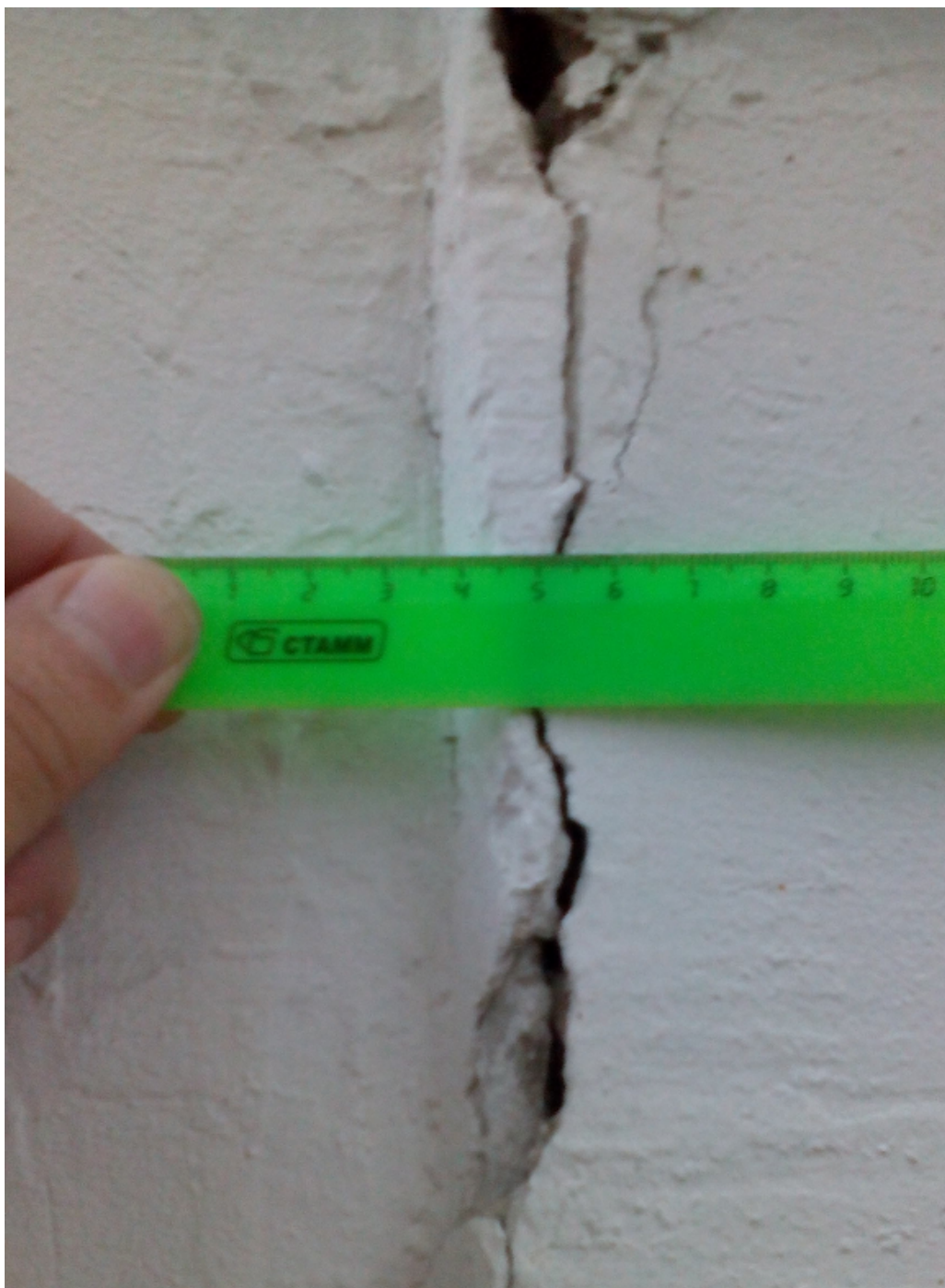
фото 5. Трещина восточной стены южного предела Храма Успения в Вешняках НАТУРАЛЬНОЙ ШИРИНЫ, соответствующей фактической ширине на дневной поверхности стены.
